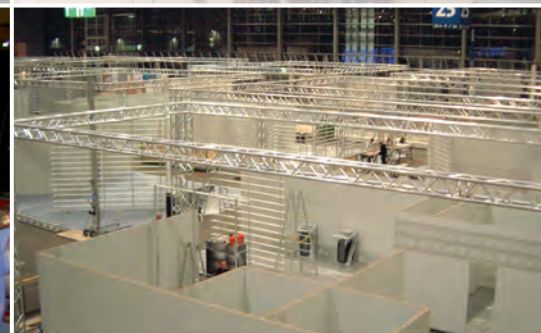
Alle Verbindungen stumpf mit nur 4 verschiedenen Verbindern. All connections are dull with only 4 different connectors.
